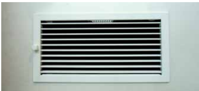
Abb.:1 Beispiel für ein geöffnetes verstellbares Gitter (nicht in jeder Anlage verbaut)
