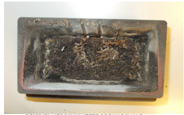
BEISPIEL VERSCHMUTZTE BRENNSCHALE
