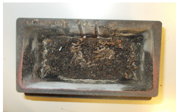
BEISPIEL VERSCHMUTZTE BRENNSCHALE
